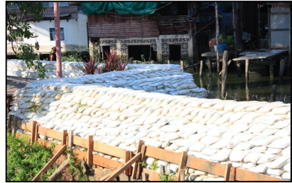
รูปที่ 6 แสดงคันกั้นน้ำกระสอบทรายที่สุขุมวิท 50
