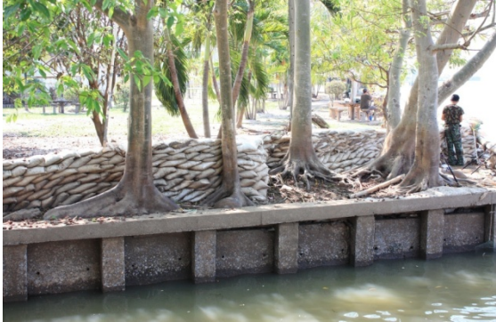
รูปที่ 4 แสดงคันกั้นน้ำกระสอบทรายที่ปากเกร็ด
